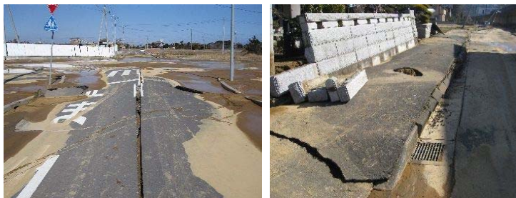
写真-1 液状化被害状況
